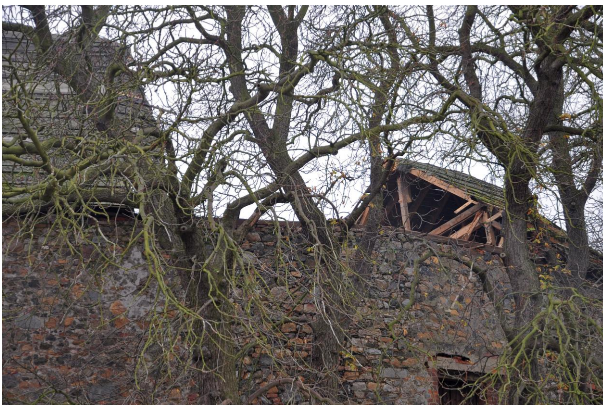
detail zřícené části střechy
