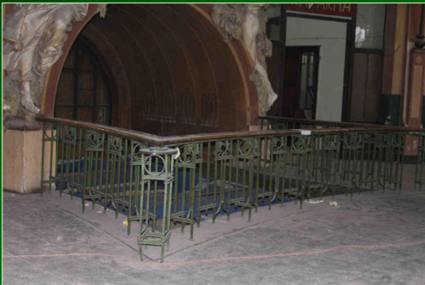
Obr. 10: stav zábradlí a dlažby před renovací.
