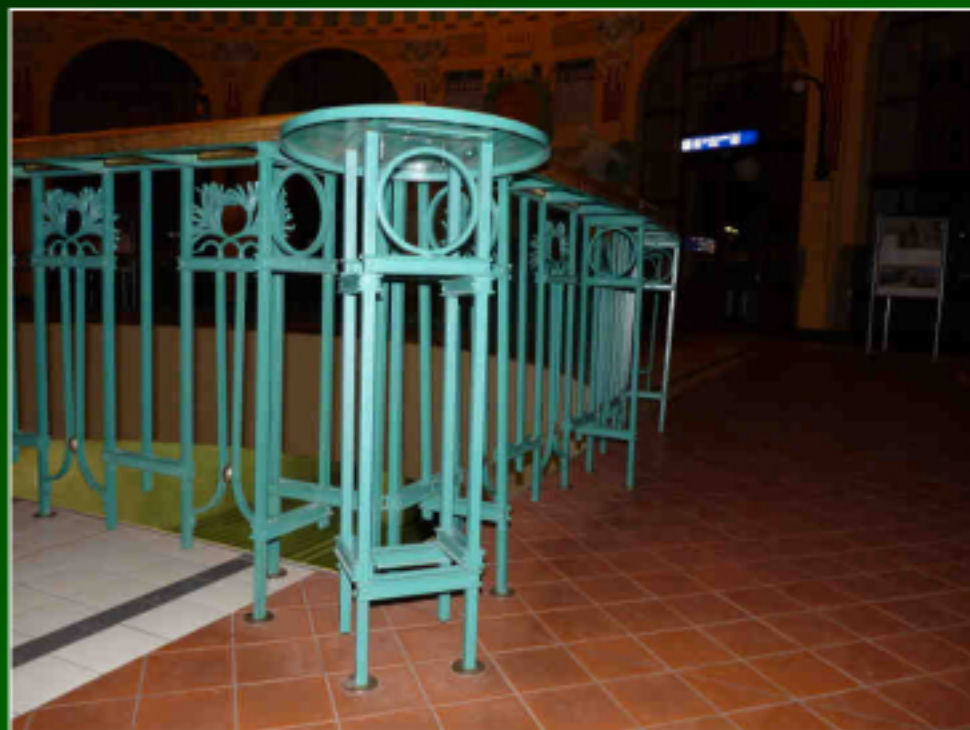
Obr. 1: detail nevzhledně přesahujících šroubů.
