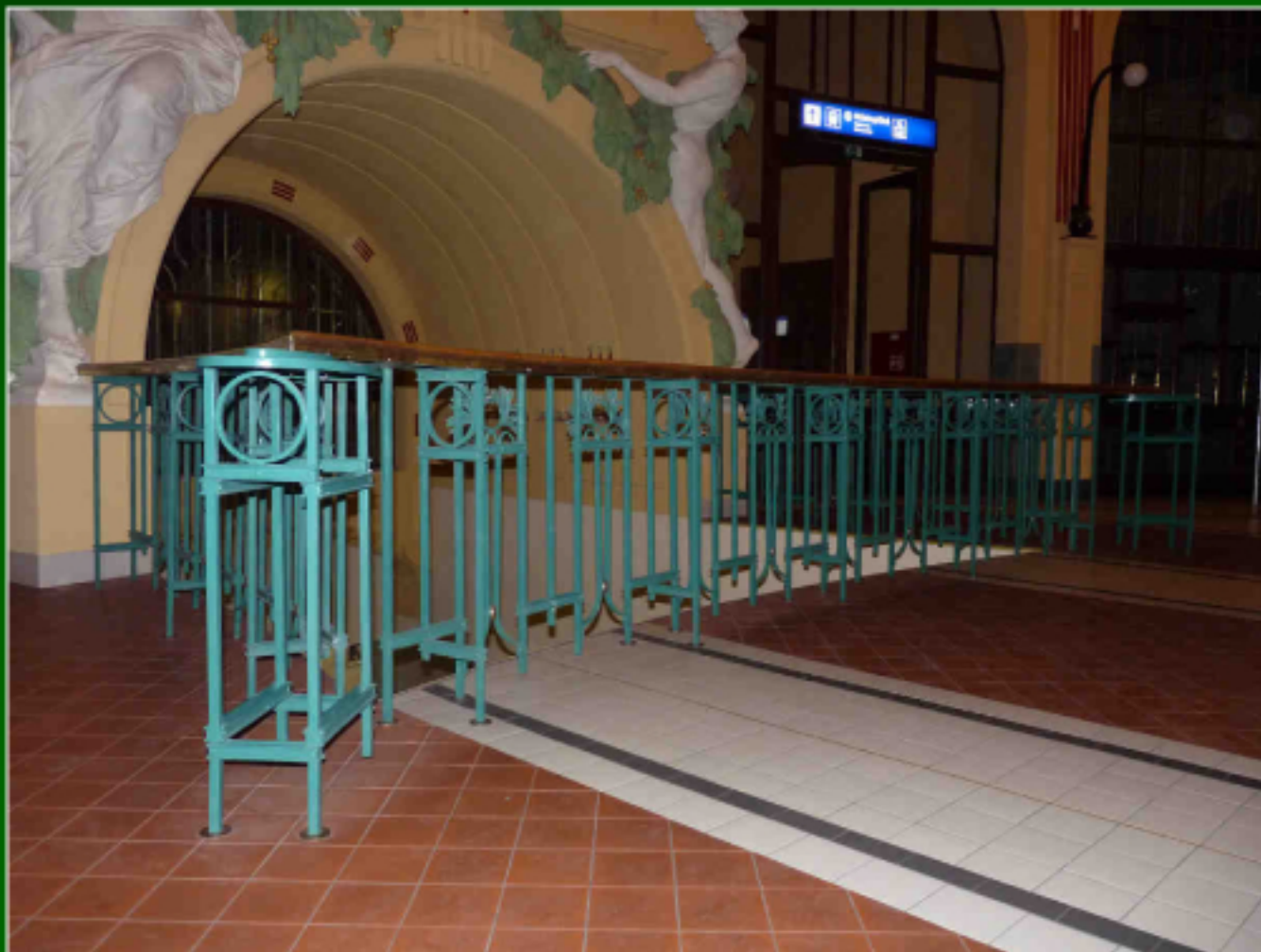
Obr. 11: spojovací mosazné pásky B profilu jsou zatřeny barvou. Nebyla restaurovaná secesní dlažba – vyměněna za novotvar. Polychromie plastik neodpovídá původnímu vzhledu.
