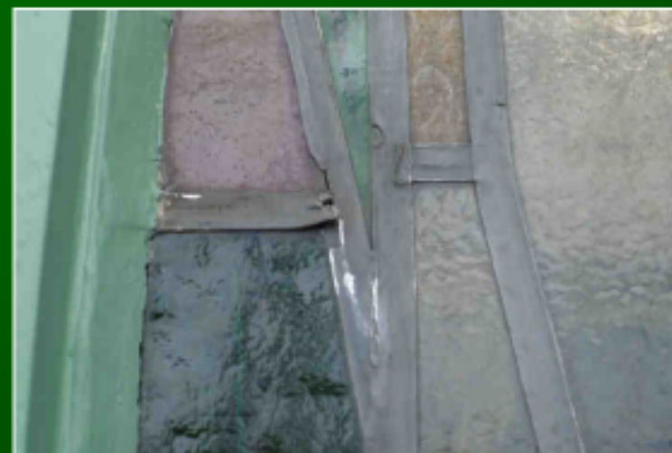
Obr. 5: obnažená hrana skla v rozpadající se olověné osnově.
