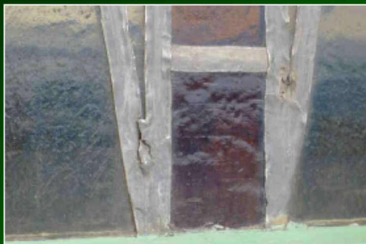
Obr. 2: poškozený olověný profil byl přihlazen ke sklu, kdy poškození v podobě prasklin umožňující zatékání, zůstalo.
