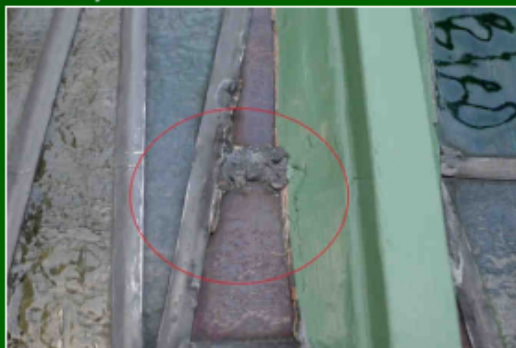
Obr. 4: detail chybějící krycí části olověného profilu.
